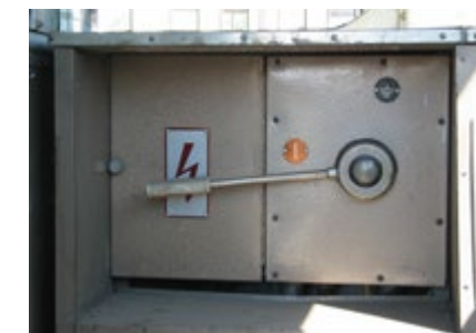
SKŘÍŇKA ODPOJOVAČE TRAMVAJÍ T3 STARŠÍHO PROVEDENÍ DLE VOZŮ Č. 6755–6992. PÁKA JE PŘESTAVENA DO POLOHY „ZAPNUTO“, U KOŘENE PÁKY JE PATRNÉ LOGO ČKD KRYJÍCÍ BLOKOVACÍ TLAČÍTKO, POD PIKTOGRAMEM BLESKU JSOU DVÍRKA KRYJÍCÍ POJISTKY 600 V, KTERÁ LZE OTEVŘÍT AŽ PO PŘESTAVENÍ PÁKY DO POLOHY „UZEMNĚNO“. HORNÍ DESKA STOLKU JE VÝKLOPNÁ, NA SPODNÍ STRANĚ JE VÝSTRAŽNÝ NÁPIS FOTO: ROBERT MARA
