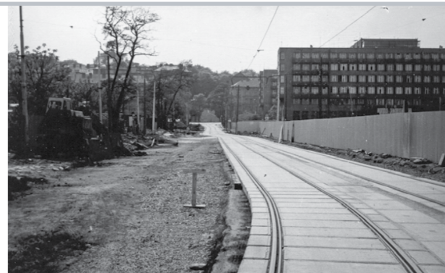
ČERSTVĚ DOKONČENÁ PANELOVÁ TRÁŤ V ULICI ZA ŽENSKÝMI DOMOVY Z 31. KVĚTNA 1980. STEJNÉ PANELE A KOLEJNICE BYCHOM TAM VESMĚS NAŠLI I DNES FOTO: JIŘÍ ČERMÁK
