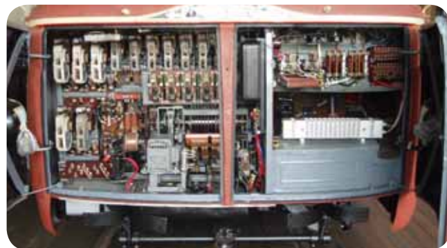
Dobře opravená elektrická výzbroj ve stykačové skříně, tzv. „kredenci“. Foto: J. Gottwald
