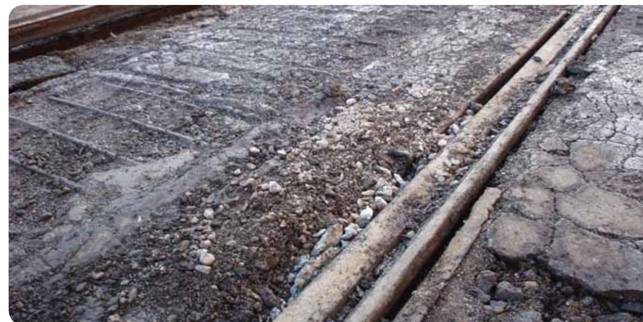
BKV panely na křižovatce s Vaničkovou ulicí byly zcela rozpadlé.
