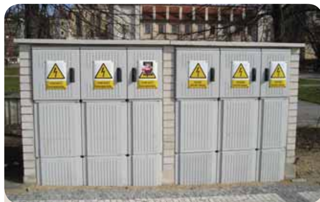
Napájecí a zpětná dělicí skříně na Palackého náměstí.
