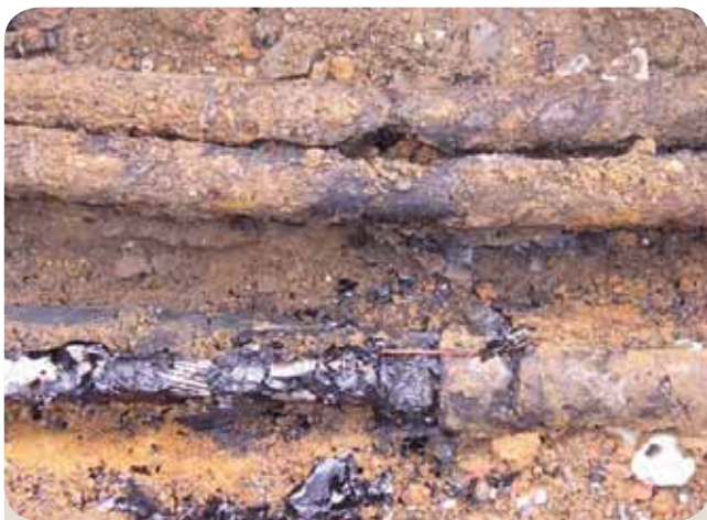
Porucha „hadrového“ kabelu v roce 2006
